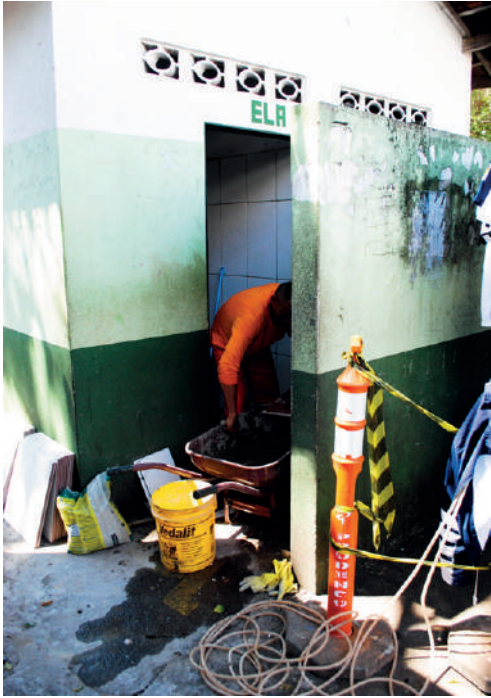
A reforma dos banheiros foi feita pela Prudenco e o parque de obra é fruto da reivindicação dos camelôs
