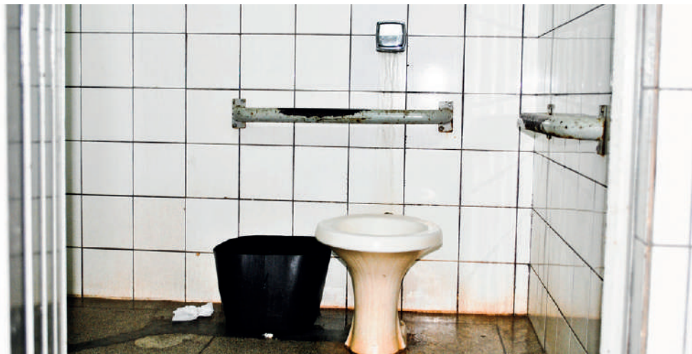
Situação do banheiro feminino antes da reforma feita pela Prudenco.
